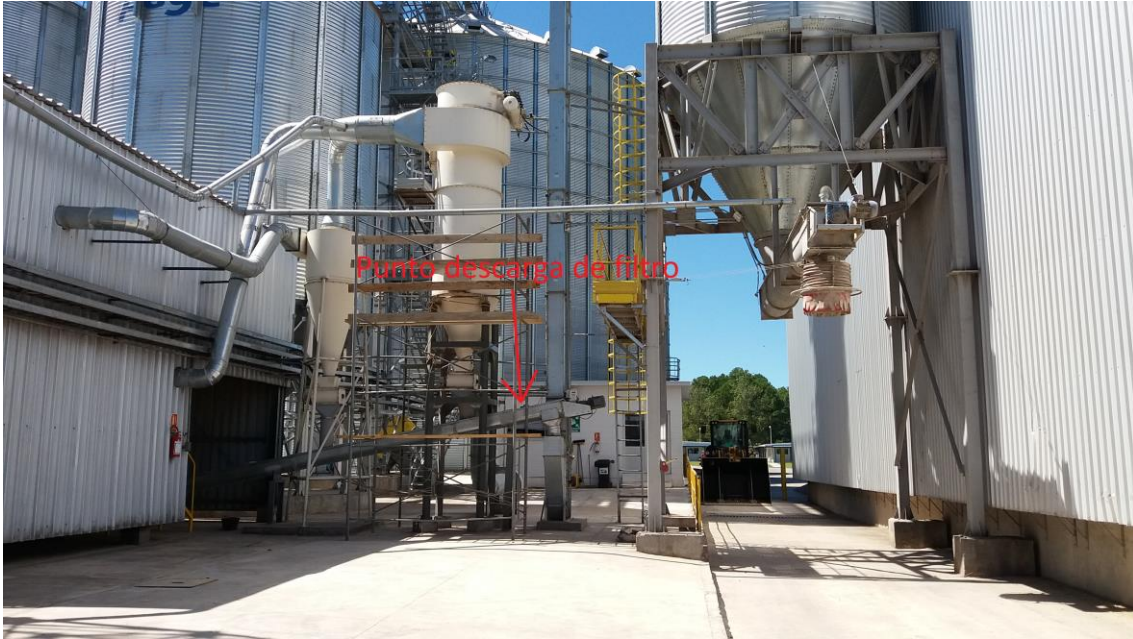
Ilustración 4 Punto de descarga de polvo del nuevo sistema de aspiración
